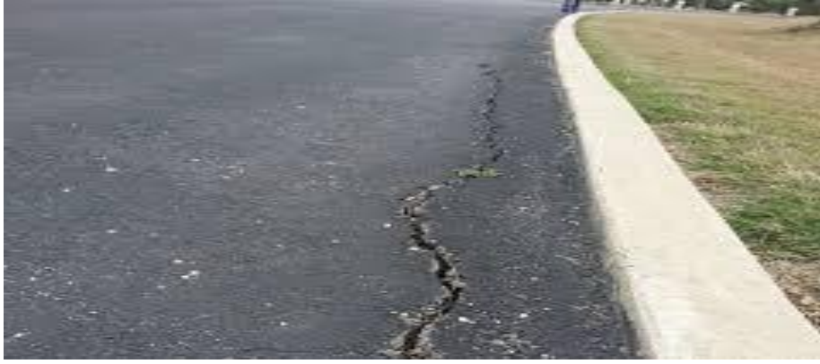
الشكل يوضح شقوق حواف الرصف
